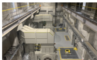
新青海川発電所（所内）
