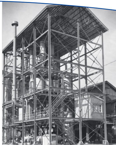
酢酸の原料となるアセトアルデヒド蒸留装置
