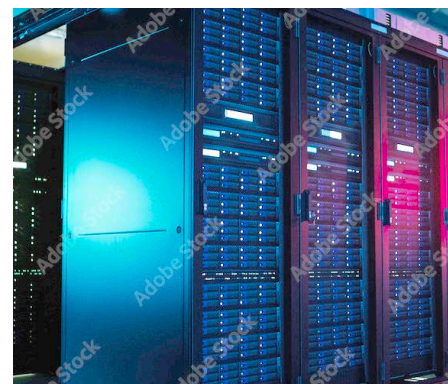
データセンターの使用例
