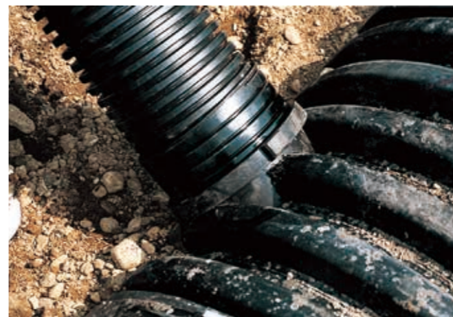
ゴム支管接続部
