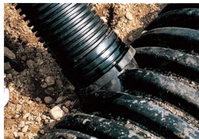
ゴム支管接続部
