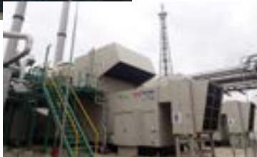
2022年开始运行的千叶工厂的燃气轮机发电设备
