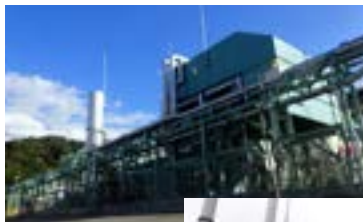
2020年开始运行的青海工厂的燃气轮机发电设备
