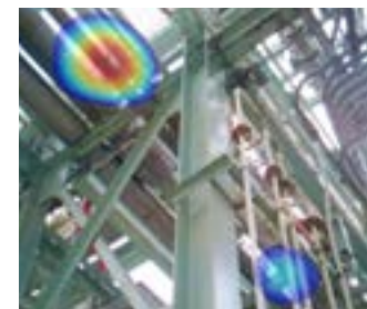
泄漏检测摄像头应用案例 ※对模拟泄漏部位进行着色显示
