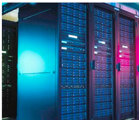
数据中心的使用案例
