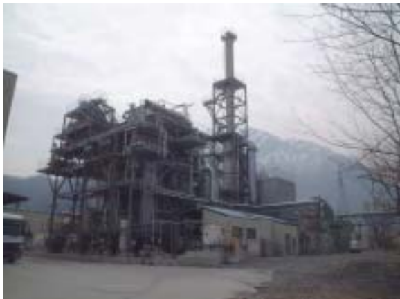
商業運転を開始した バイオマスボイラー
