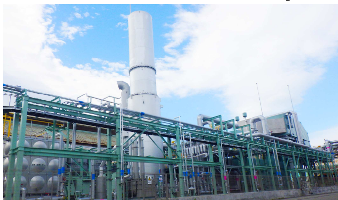
＜青海工場の高効率ガスタービン発電機＞
