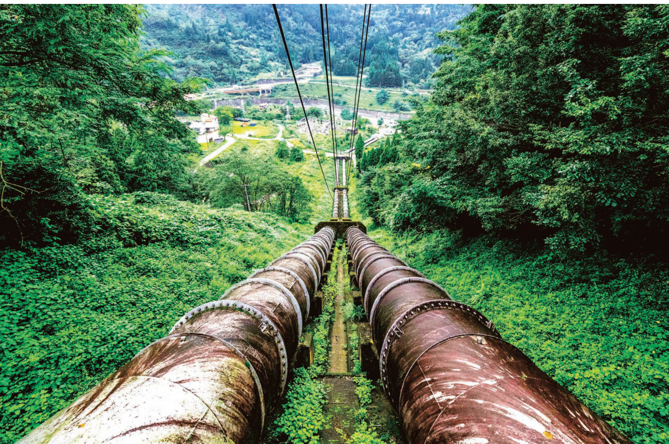
大網水力発電所(長野県)
