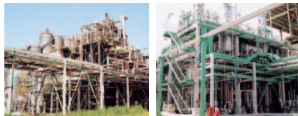
増強された透明樹脂、耐熱樹脂各製造プラント(千葉工場)
