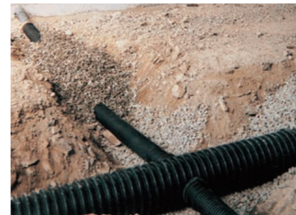
▲ トンネルセンタードレン
