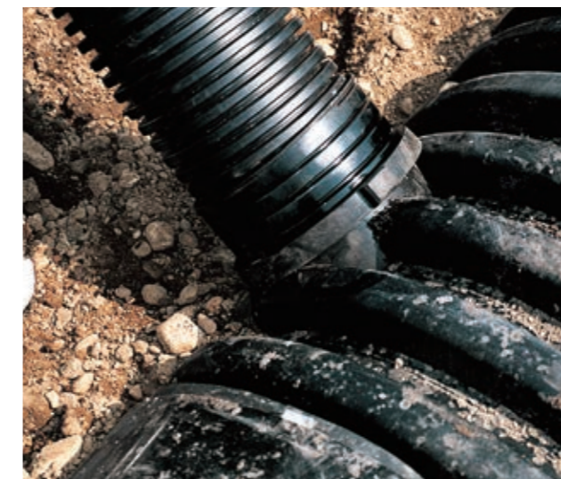
▲ ゴム支管接続部
