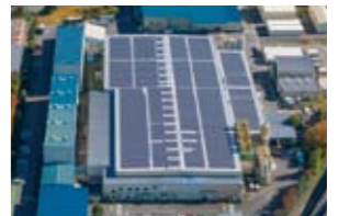
屋根に張り巡らされた太陽光発電設備
