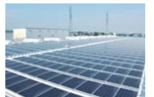
太陽光発電設備 (太田地区建屋の屋根に設置)
