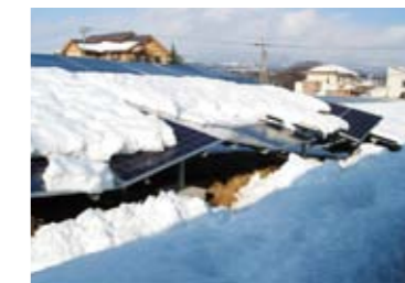
DENKAソーラーパワーしづかわの雪害
