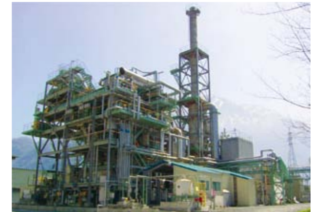
バイオマスボイラー
