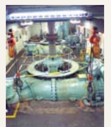
水力発電所内部
