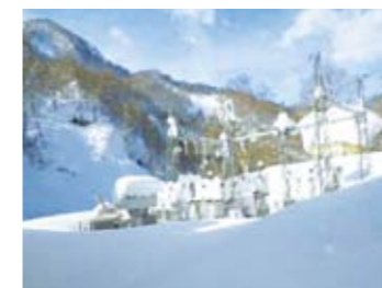
冬の送電設備
