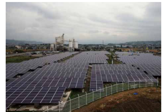
稼働中のメガソーラー(2013年7月撮影)
