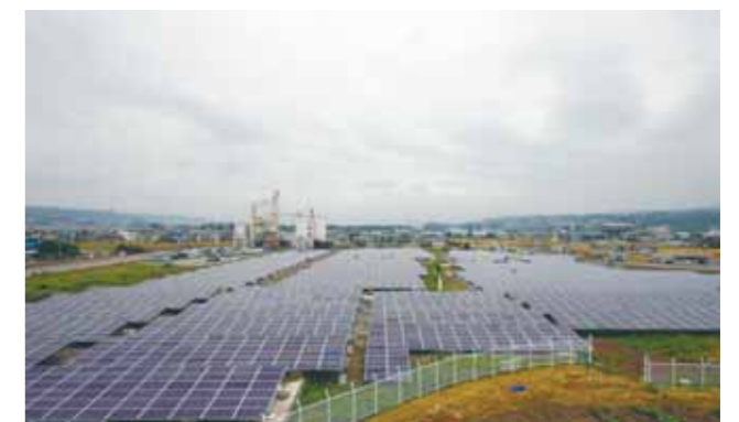
竣工したDENKAソーラーパワーしづかわ
