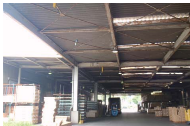
屋内吊りワイヤー
