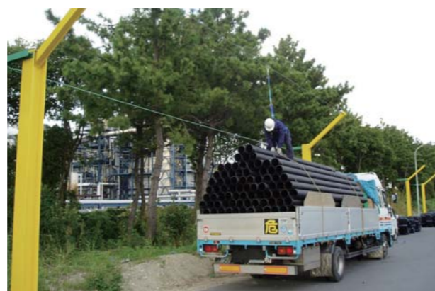
屋外吊りワイヤー
