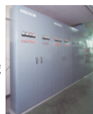
接着工法採用例：配電盤
