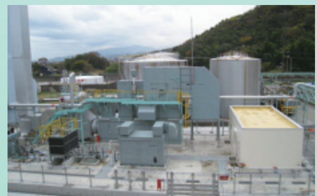
青海工場海火力ガスタービン
