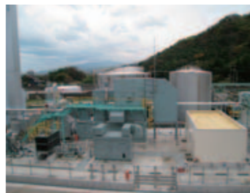
青海工場海火力ガスタービン
