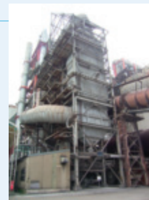
セメント排熱ボイラー
