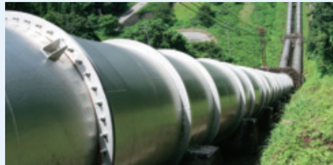
大網発電所 水圧鉄管
