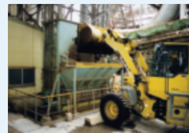
廃タイヤ投入設備
