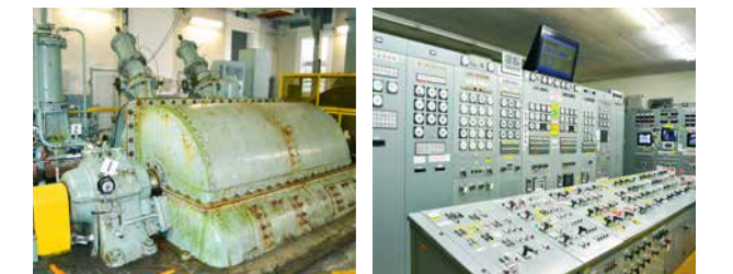
海川第3発電所のペルトン水車
