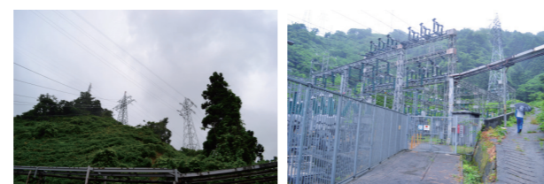
水力発電所の電力を山を越えて工場へ運ぶ送電線 各地からの電力が届く「大沢開閉所」
