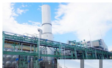
2020年に運転を開始した青海工場のガスタービン発電設備
